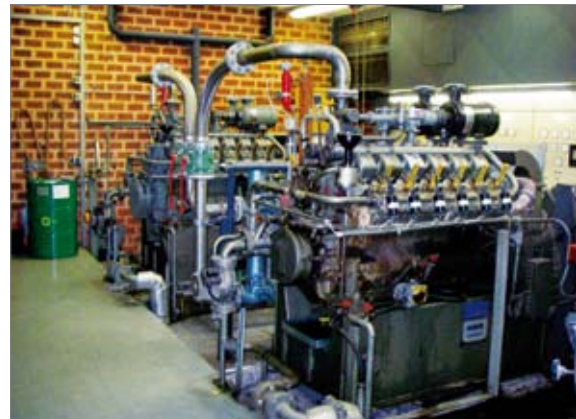
Gasmotorenanlage Klärwerk Mettmann
