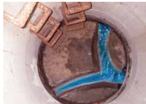
Feststellung von Fehleinleitungen
