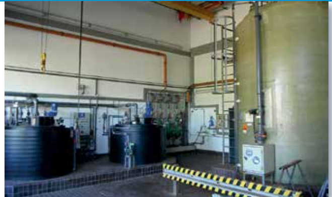
Fällmittelstation Klärwerk Monheim
