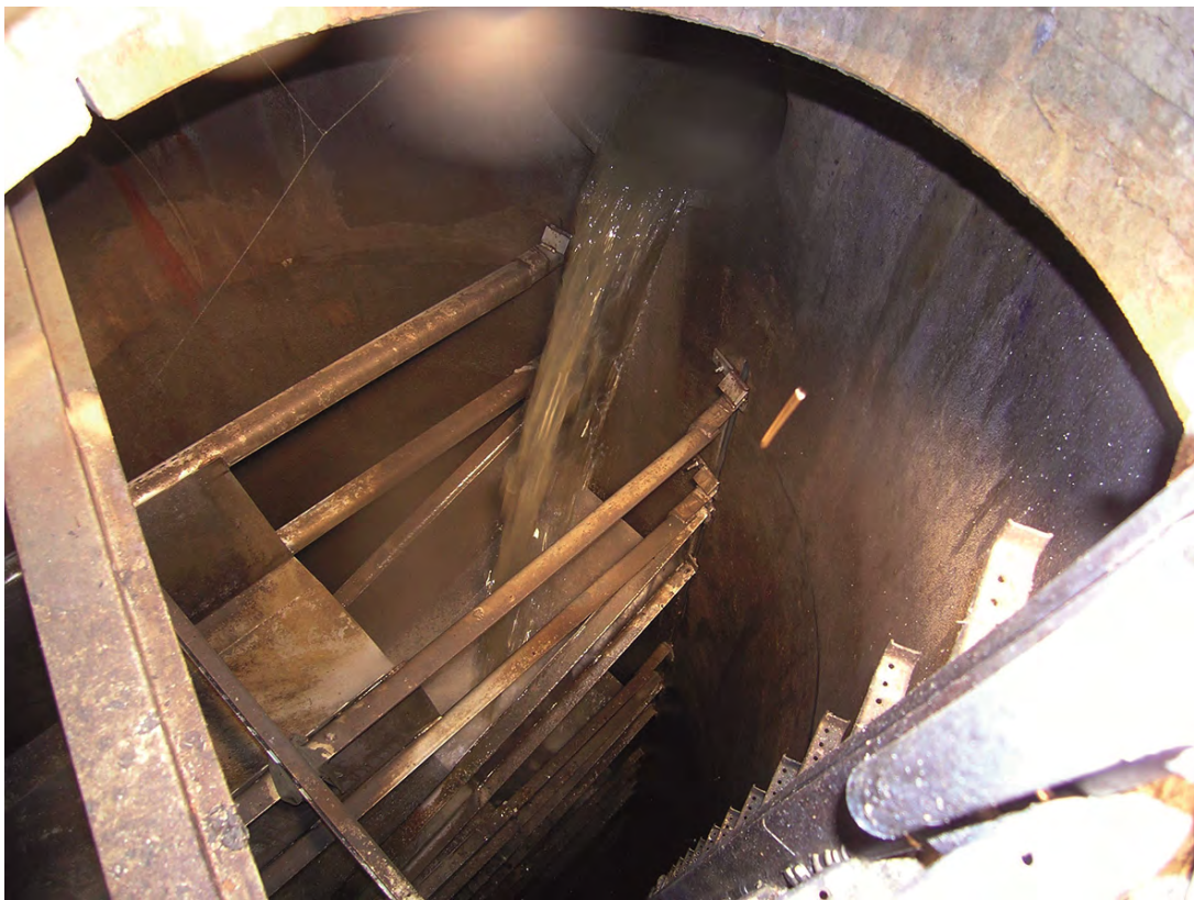
Foto: Schacht mit Kaskaden
