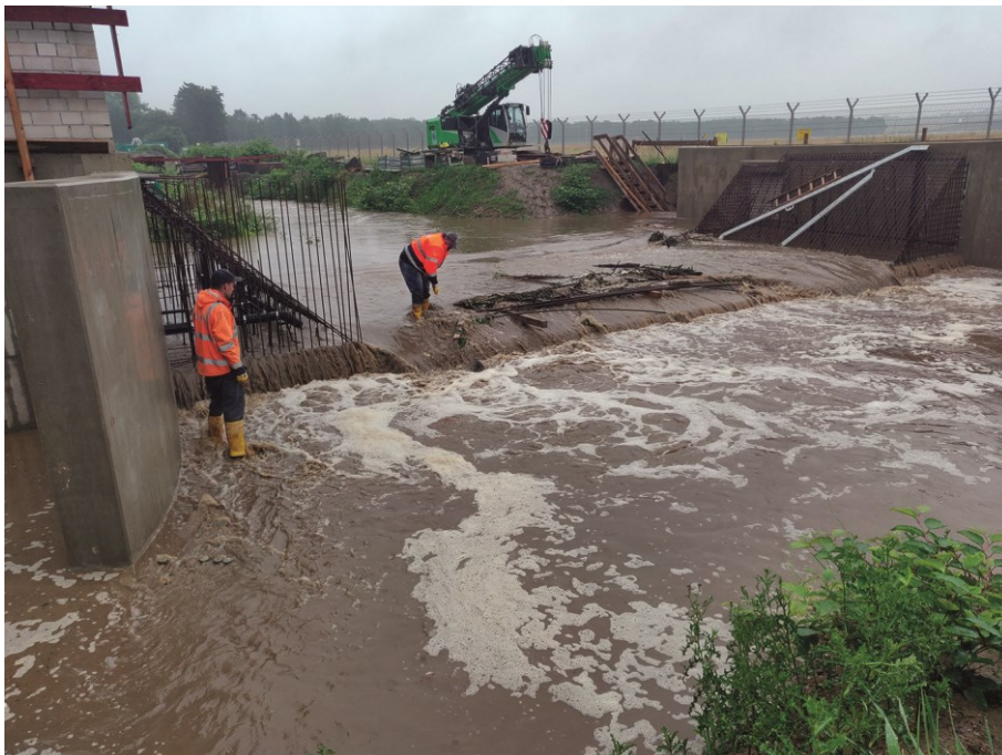
Überflutung des Schwarzbach-Entlastungsgrabens
